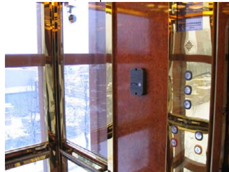
КАБИНА ЛИФТА ПРОИЗВОДСТВА ОАО «ЩЛЗ»
